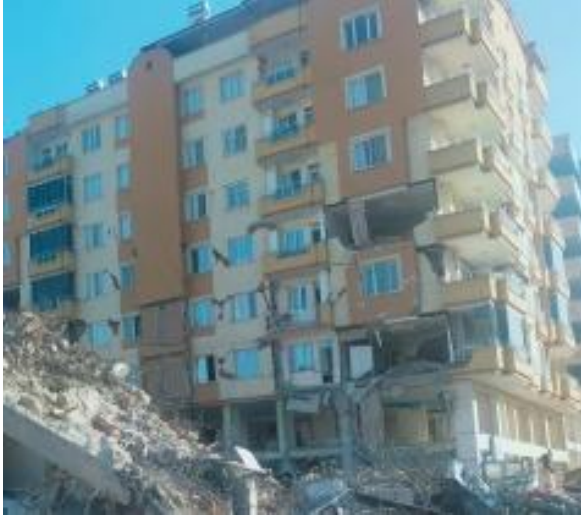
Şekil 2.11. Dolgu duvar kaynaklı hasar, Gaziantep (AFAD, 2023).
