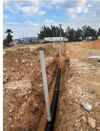
Şekil 3.12. Konteyner kentlerde kullanılan pis su-temiz su altyapı bağlantısı (AFAD röportajı, 2023).
