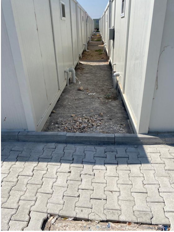
Şekil 3.9. Konteynerlerin altyapı bağlantısı (AFAD röportajı, 2023).
