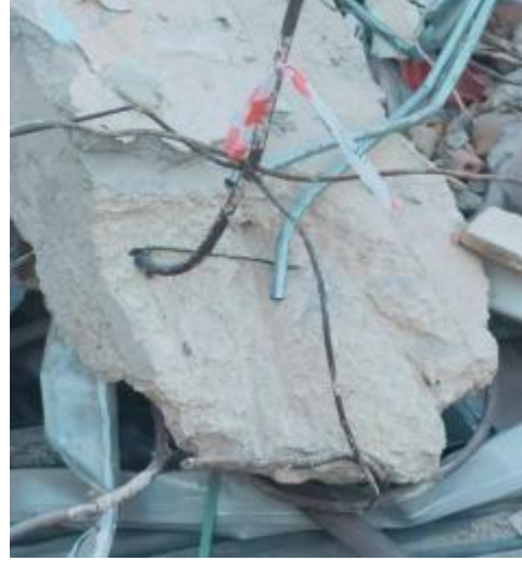
Şekil 2.12. Düz donatı kullanımı sonucu hasar, Hatay (AFAD, 2023).
