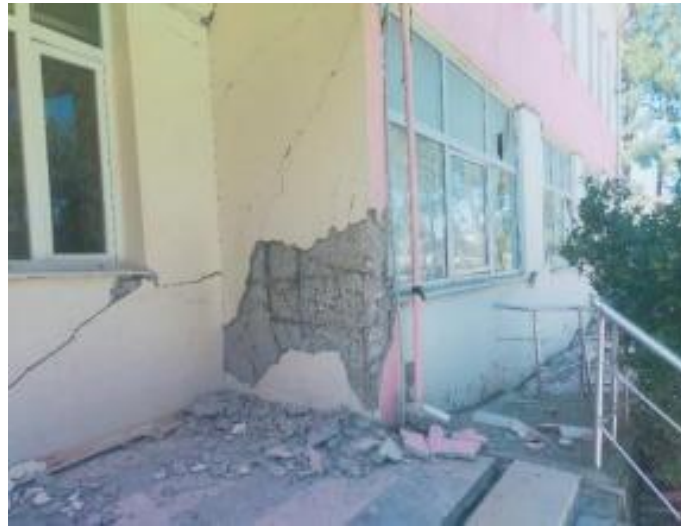
Şekil 2.13. Kısa kolon kullanımı sonucu hasar, Kahramanmaraş (AFAD, 2023).
