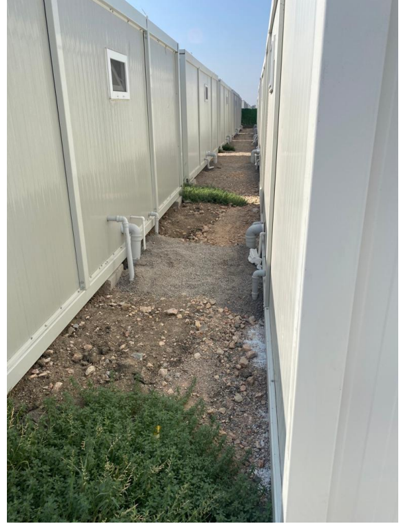
Şekil 3.10. Konteynerlerin altyapı bağlantısı (AFAD röportajı, 2023).
