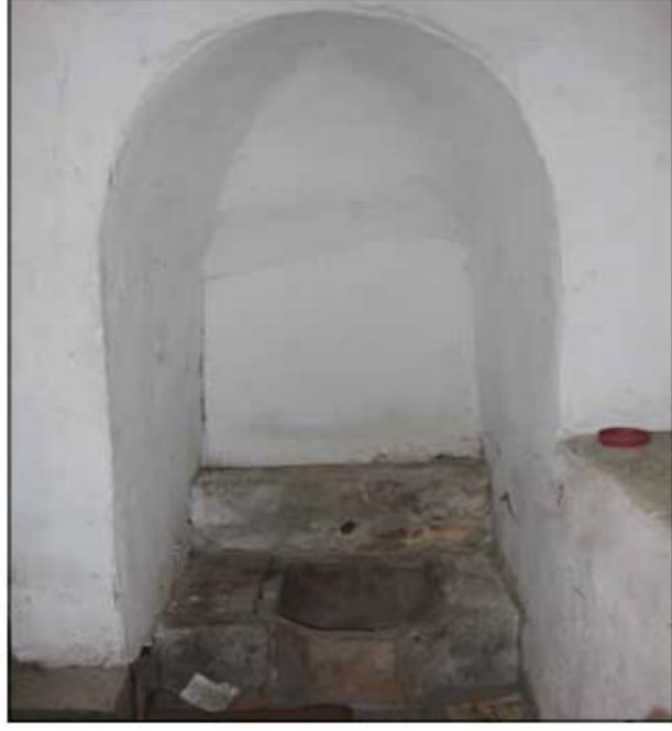
Şekil 5. 68. Atatürk Evi restorasyon öncesi merdiven başlangıç sahanlığındaki niş ve içinde bulunan çeşme [87]
