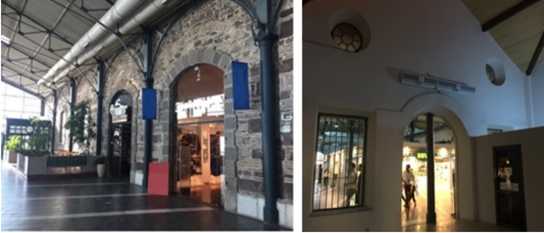
Şekil 108. Konak Pier Yapısı'nın İç Mekânda Görünen Tesisat Sistemleri Kaynak: G. Büke Doğru'nun Kişisel Arşivinden Alınmıştır.
