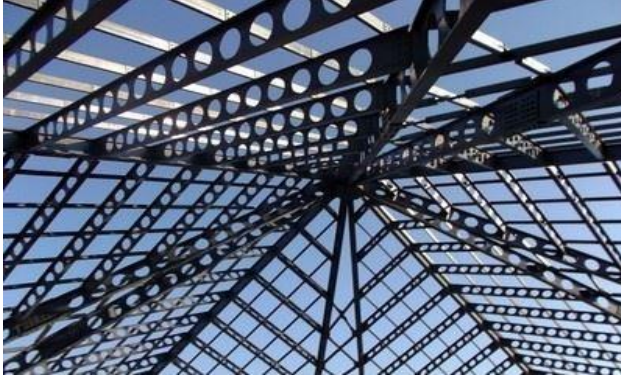
Şekil 22. Çelik Konstrüksiyon Sistemleri https://www.yapikatalogu.com/kaba-yapi/celik-konstruksiyon/tyc-ltd-celik-konstruksiyon-ve-duvarpanel_16318 Erişim Tarihi: 02.04.2020
